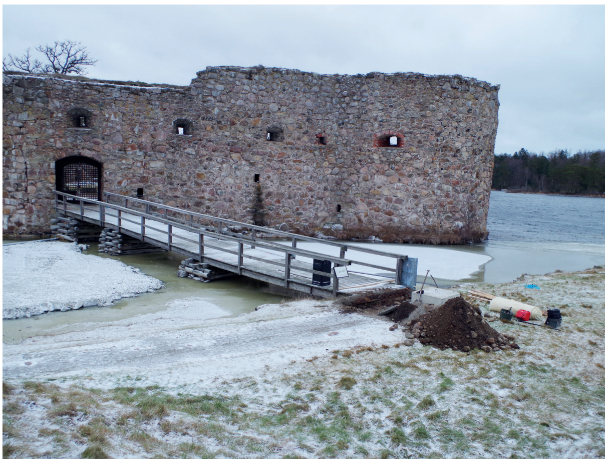
Figur 30. Schakt 1 togs upp vid fästet till bron mellan Stallholmen och Slottsholmen. Foto taget från sydväst.
